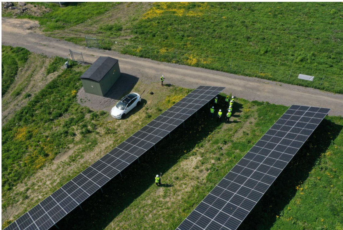
Figur 7 Foto på solpaneler, transformatorstation, nya vägar och stängsel i solparken Varberg norra, Solkompaniet ©.
