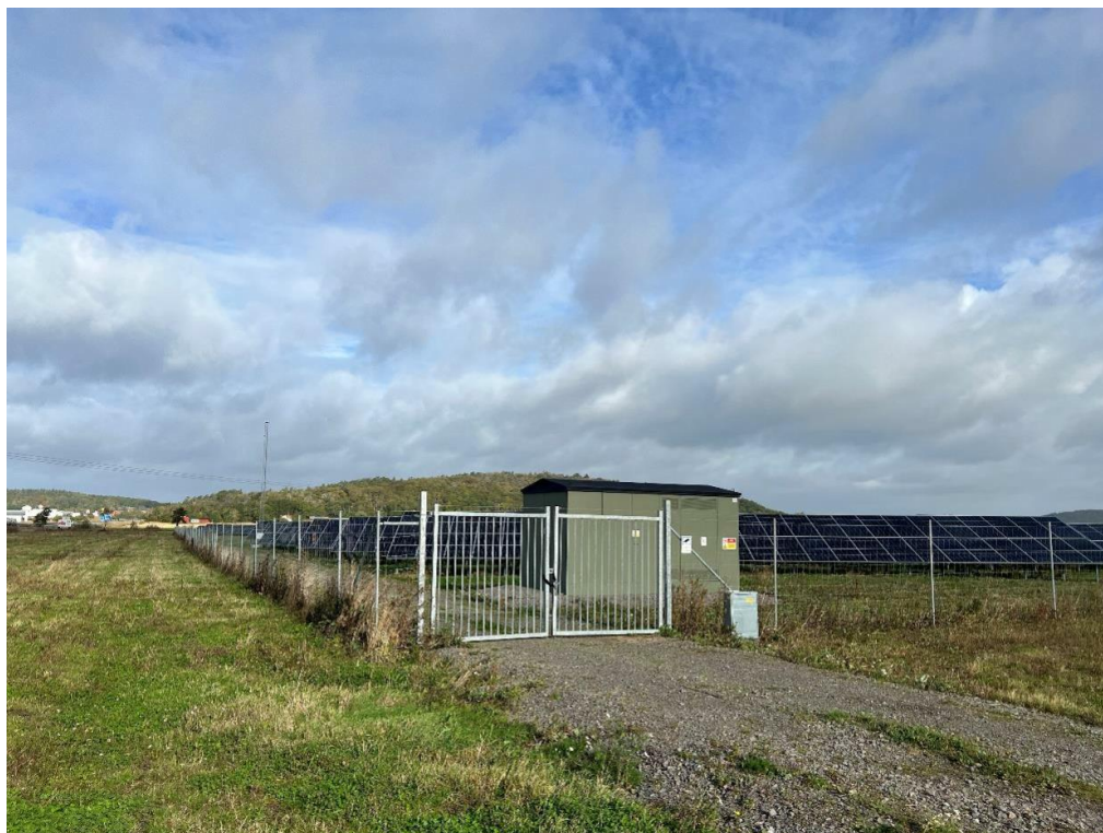
Figur 8. Exempel på staket och grind till solpark Varberg norra, Solkompaniet ©.
