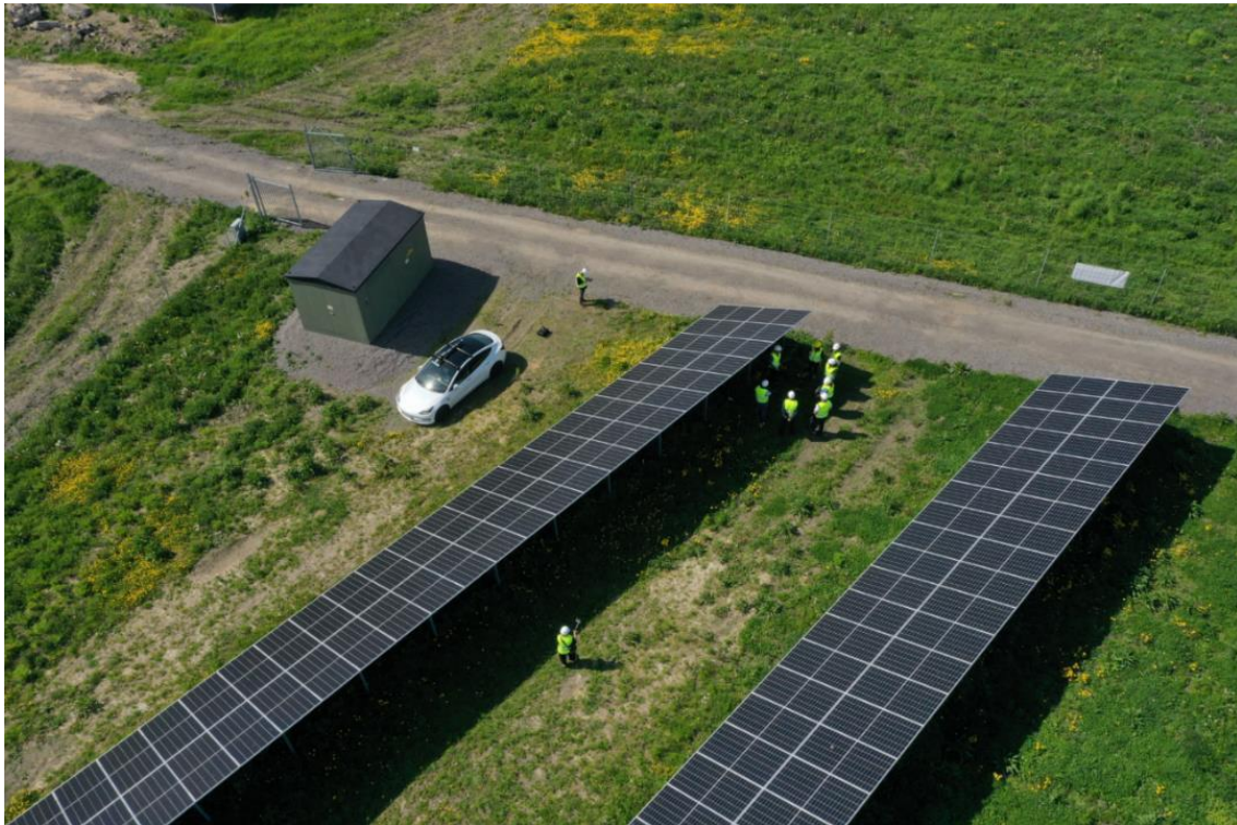
Figur 4. Exempel på utformning av solpaneler, transformatorstation, nya vägar i solparken och stängsel. Foto: Solpark Varberg Norra.
