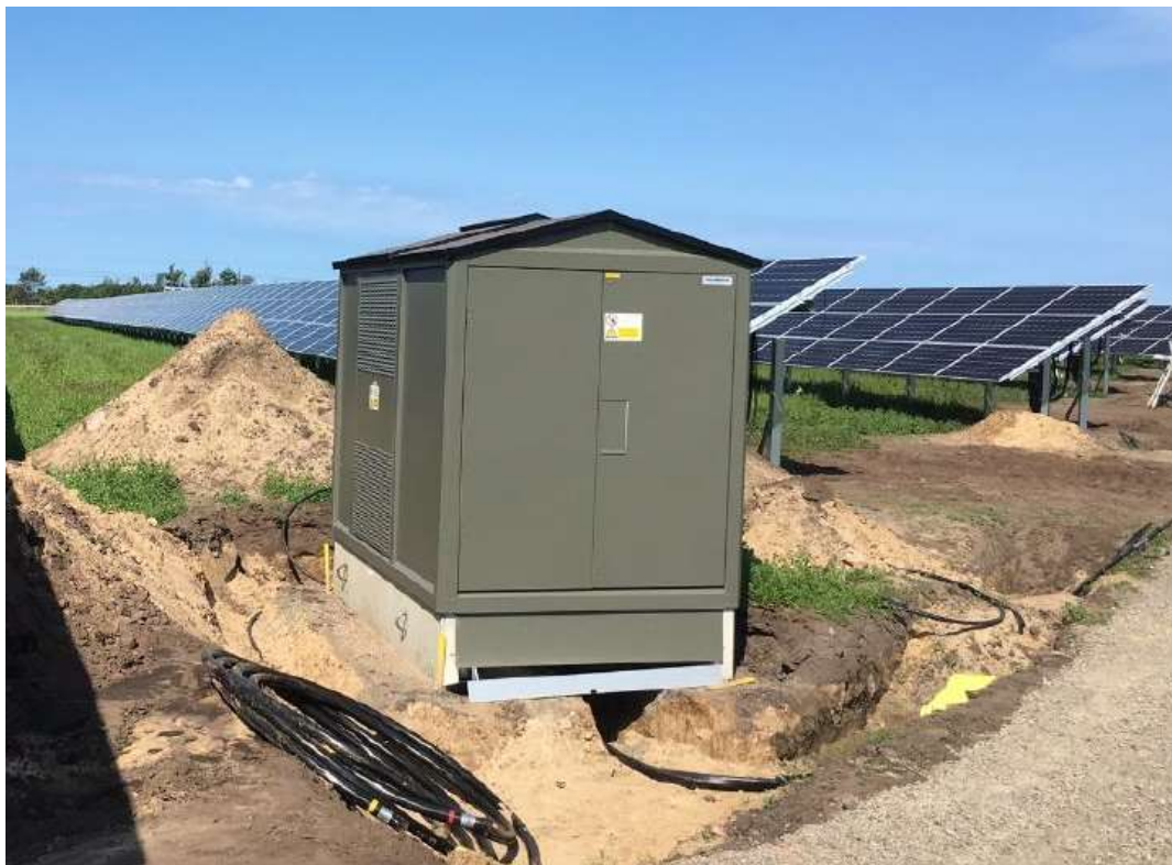
Figur 6. Exempelbild på en transformatorstation under byggnation av solcellspark i Varberg. Även kabelschakt är med på bild.
