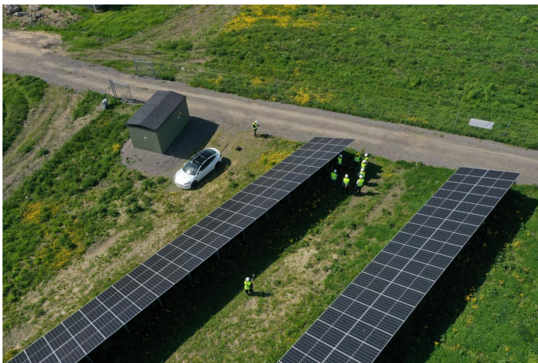
Figur 4.2.1. Foto på solpaneler, transformatorstation, vägar och stängsel.
