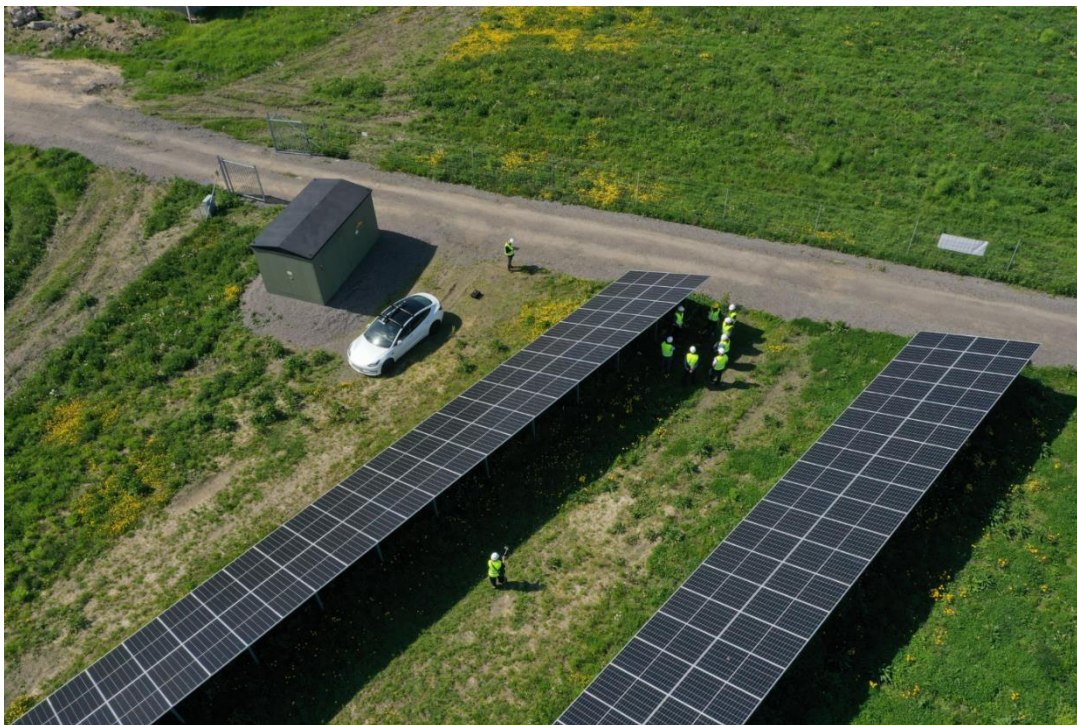
Figur 6. Foto på solpaneler, transformatorstation, nya vägar och stängsel i solpark Varberg norra.
