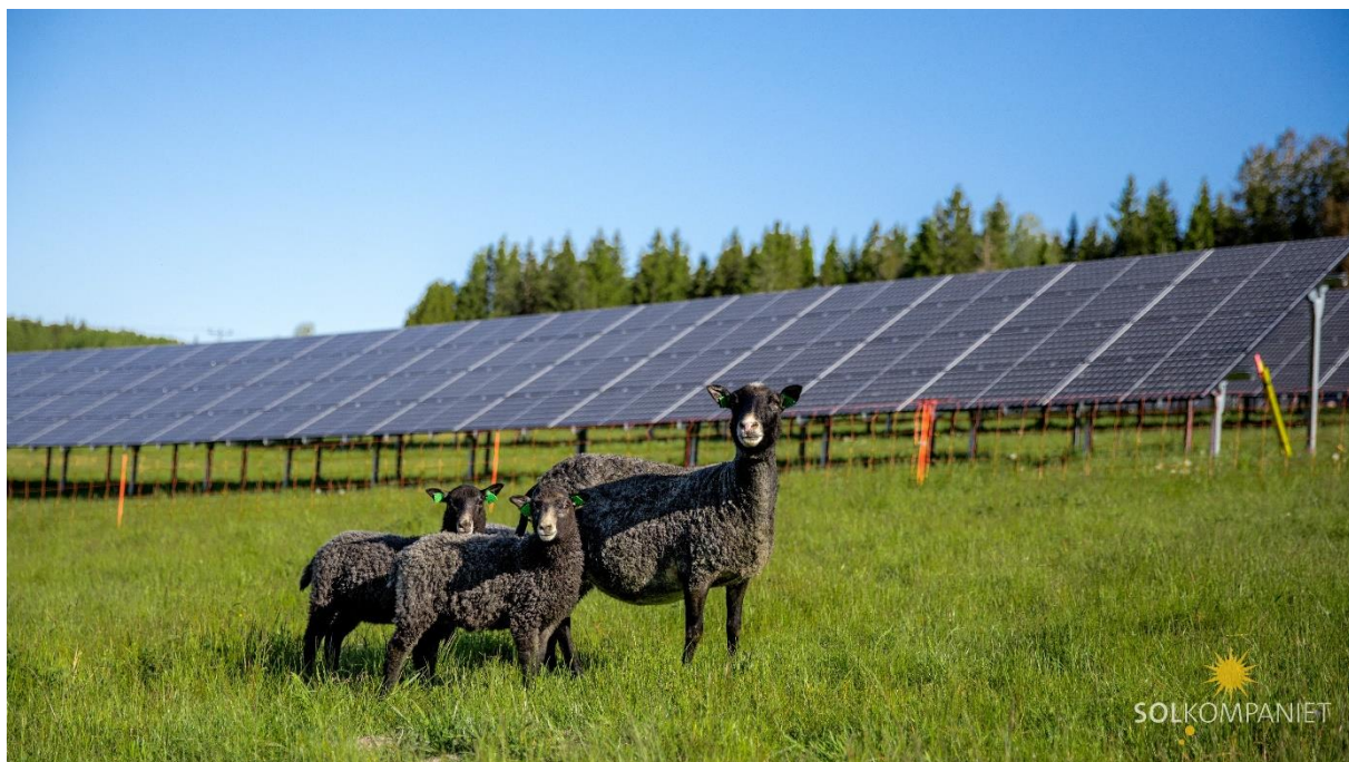
Figur 2. Foto från Linde Energis solcellspark i Torphyttan som Solkompaniet har byggt. (Foto: Solkompaniet)
