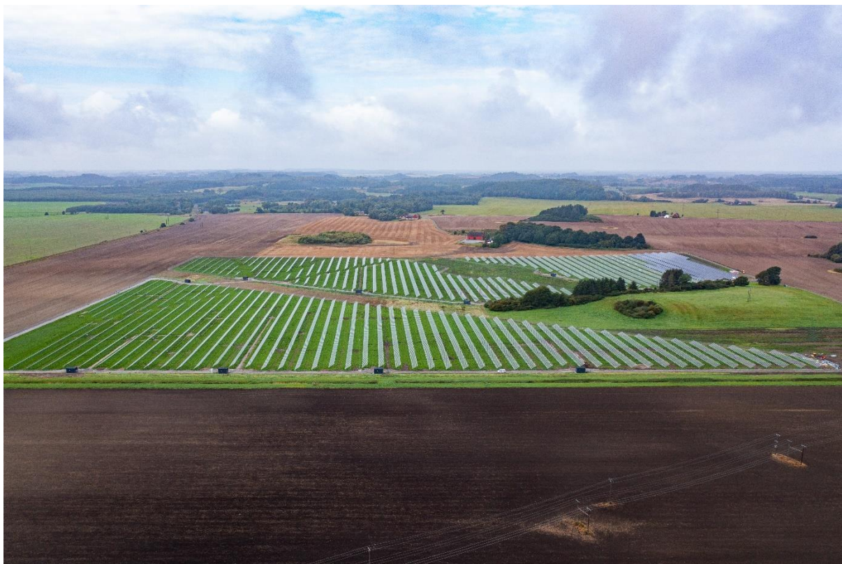
Figur 9. Solcellspark sett från sidan och snett uppifrån (foto från en annan av Solkompaniets solcellsparker). Foto: Alight.
