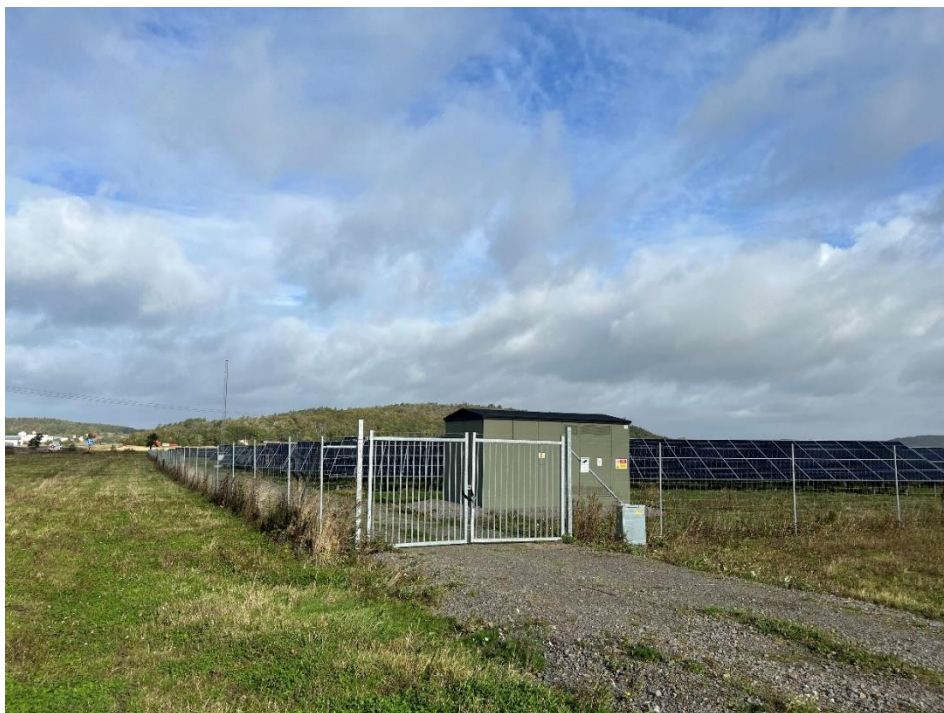
Figur 5. Exempel på utformning av staket och grind vid infart, bild tagen vid Solparken Varberg Norra.
