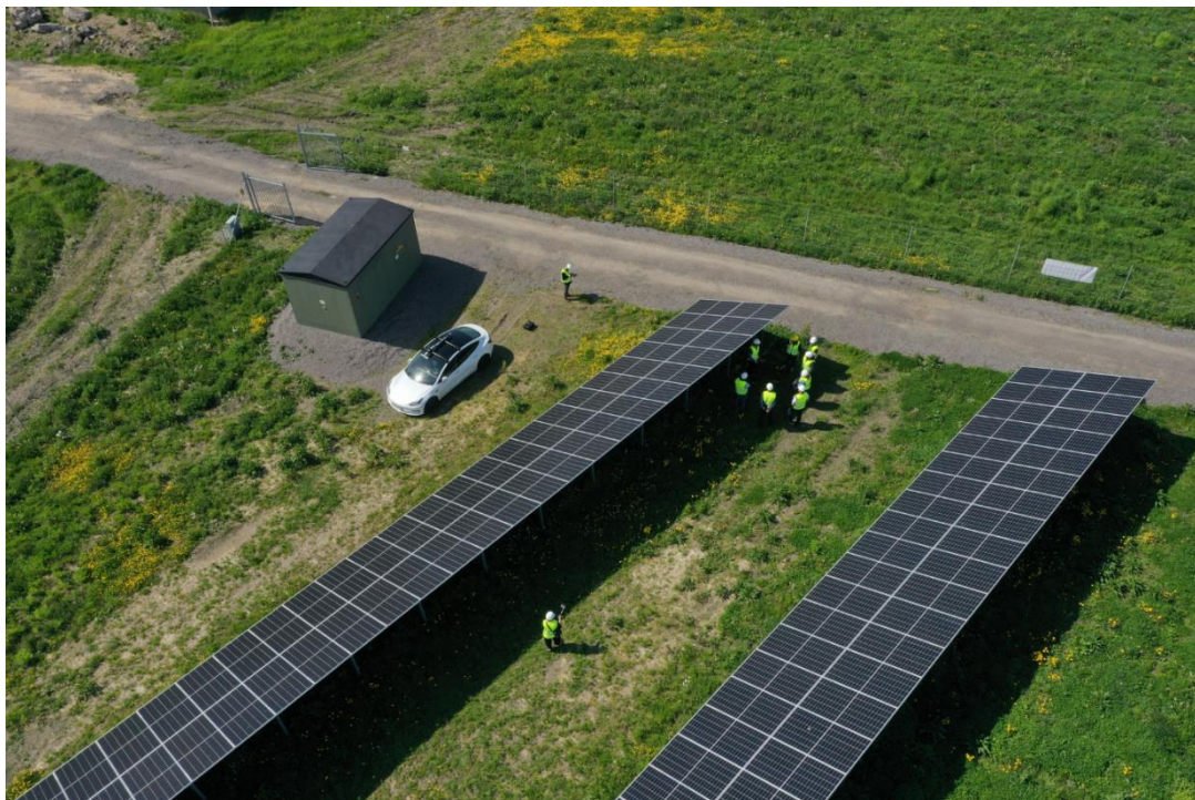
Figur 2. Foto på solpaneler, transformatorstation, nya vägar i parken och stängsel i Solpark Varberg norra.
