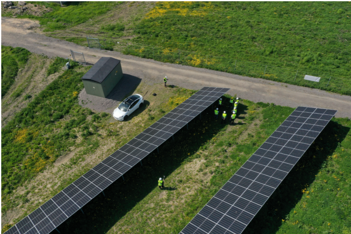
Figur 4. Solpaneler monterade i rader på markställningar och transformatorstation (byggnaden) i övre vänstra hörnet av bilden (Foto: Solkompaniet, Niclas Bengtsson).
