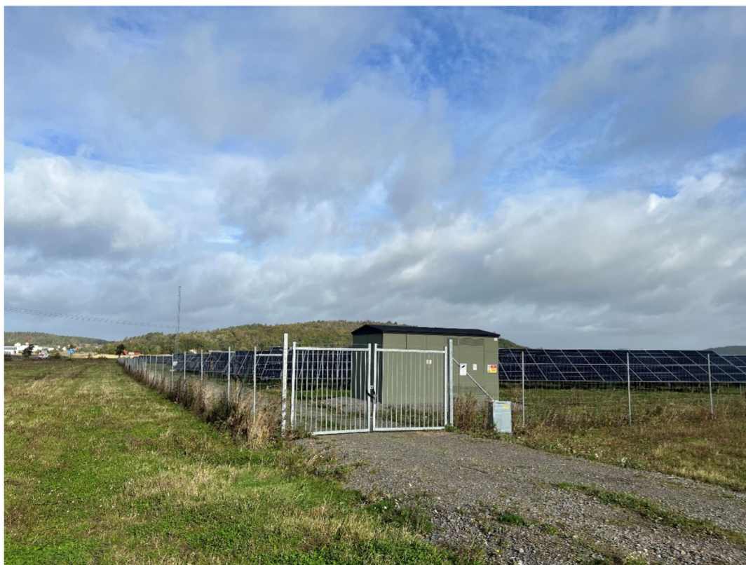
Figur 7. Exempel på staket och grind vid infarten till Solpark Varberg Norra, bakom staketet syns en transformatorstation och rader av solpaneler på markställningar (Foto: Solkompaniet).
