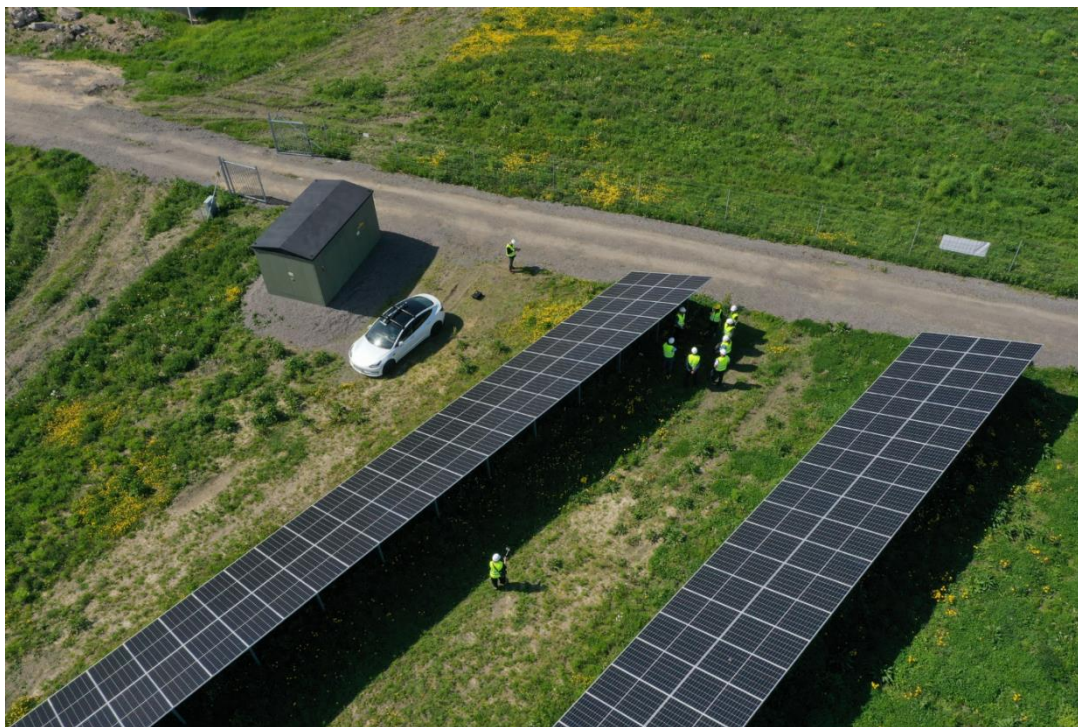
Figur 4 Foto på solpaneler, transformatorstation, nya vägar i parken och stängsel i Solpark Varberg norra.
